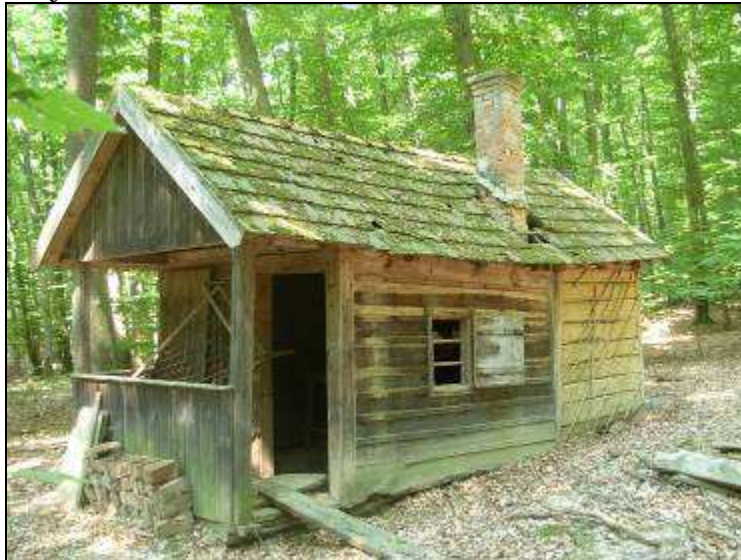
Leromlott állapotú munkás melegedő bóde
